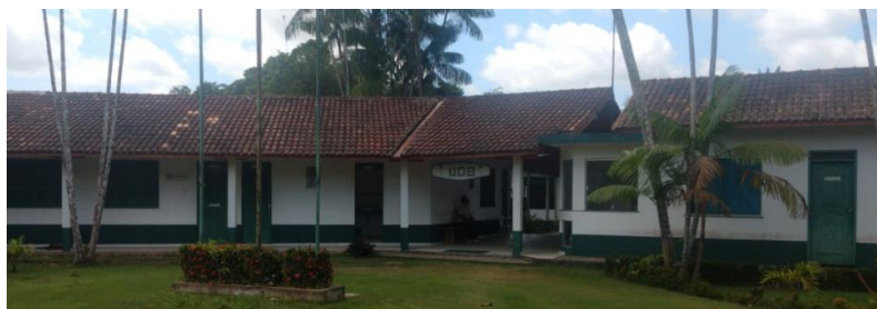
FOTO 09: PRÉDIO PRINCIPAL (UDB) – INFILTRAÇÕES E PINTURA EXTERNA
