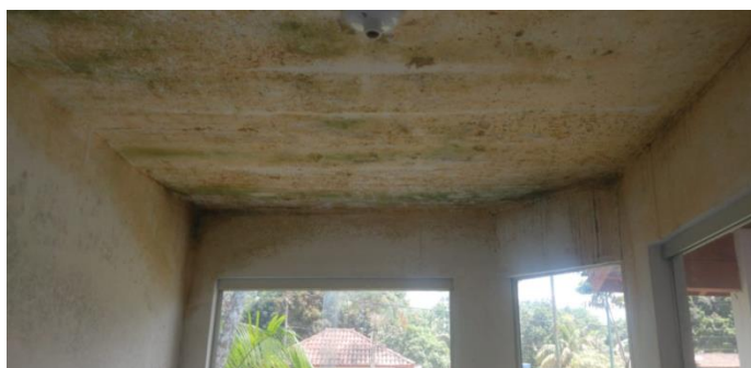
FOTO 10: PRÉDIO PRINCIPAL (UDB) - UMIDADES INTERNA E INFILTRAÇÕES
