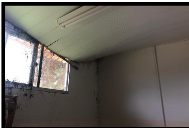
FOTO 02: LATICÍNIOS – FORRO PVC EM DESABAMENTO
