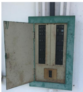
FOTO 06: SETOR DE FRUTAS – INSTALAÇÕES ELÉTRICAS EM DESACORDO COM A LEGISLAÇÃO VIGENTE
