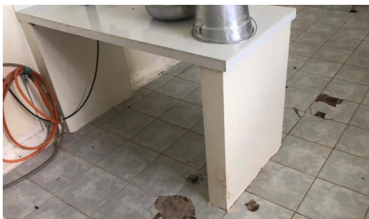
FOTO 05: SETOR DE FRUTAS - ESTADO DE CONSERVAÇÃO DO PISO
