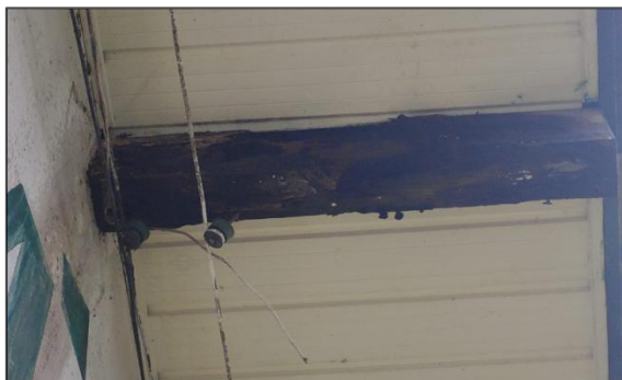
FOTO 03: ESTADO DE CONSERVAÇÃO DA ESTRUTURA DE MADEIRA DO TELHADO E INSTALAÇÕES ELÉTRICAS
