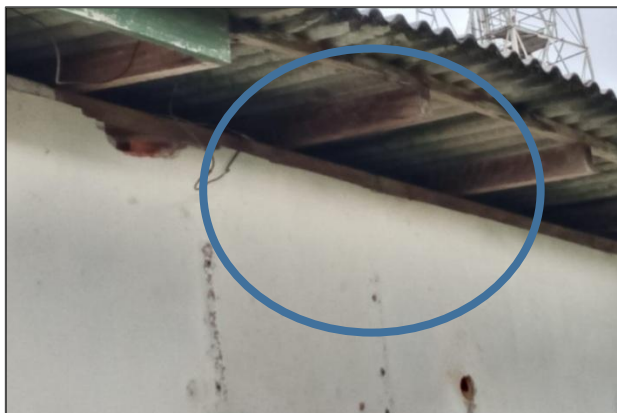
FOTO 04: ABERTURAS LATERAIS DE ACESSO AO FORRO PARA MORCEGOS E INSETOS
