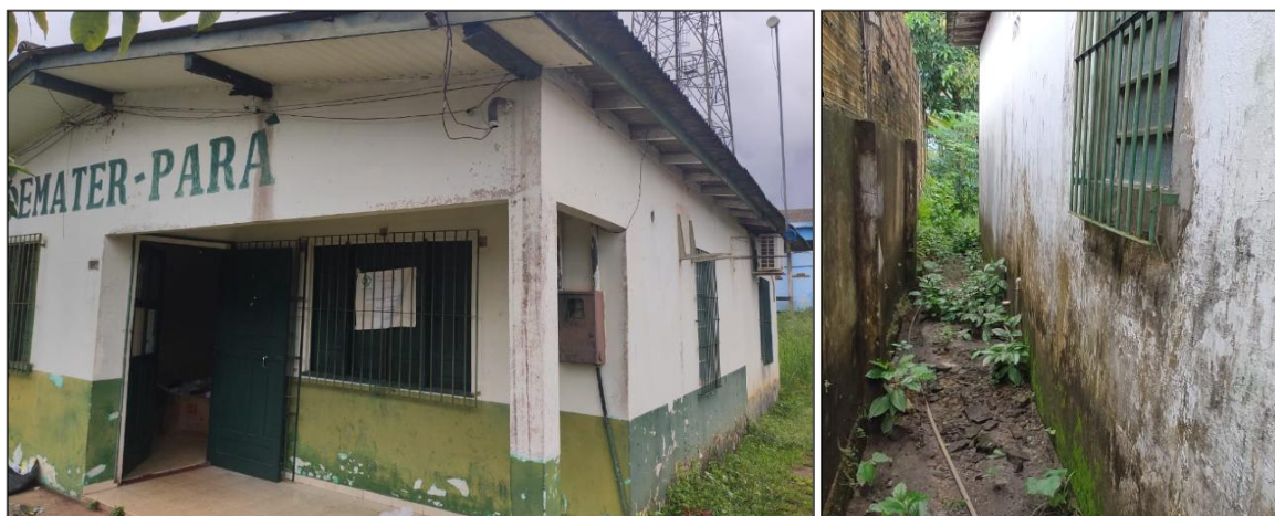
FOTO 01: ESTADO DE CONSERVAÇÃO DO ESLOC E UMIDADE EXTERNA
