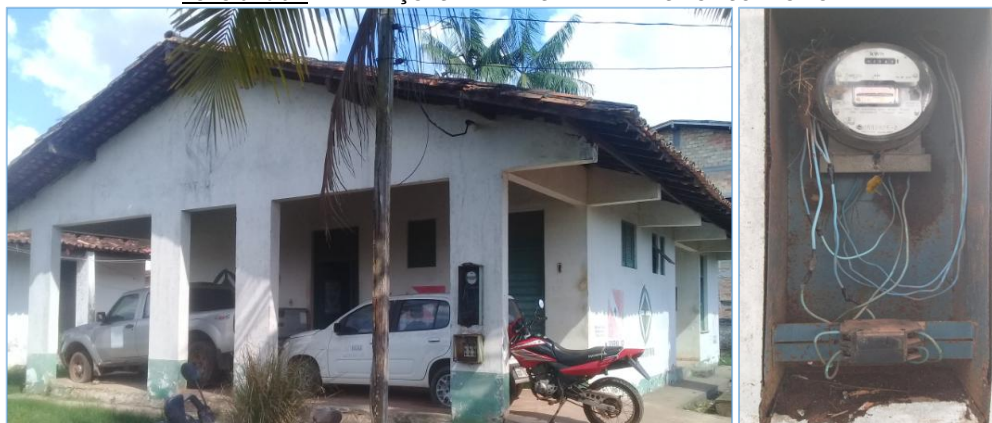
FOTO 03 e 04: ESTADO DE PINTURA E QUADRO DE ENERGIA ELÉTRICA
