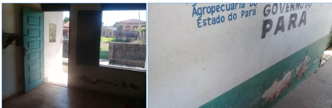
FOTO 01 e 02: INFILTRAÇÕES INTERNAS E EXTERNAS DO ESCRITÓRIO
