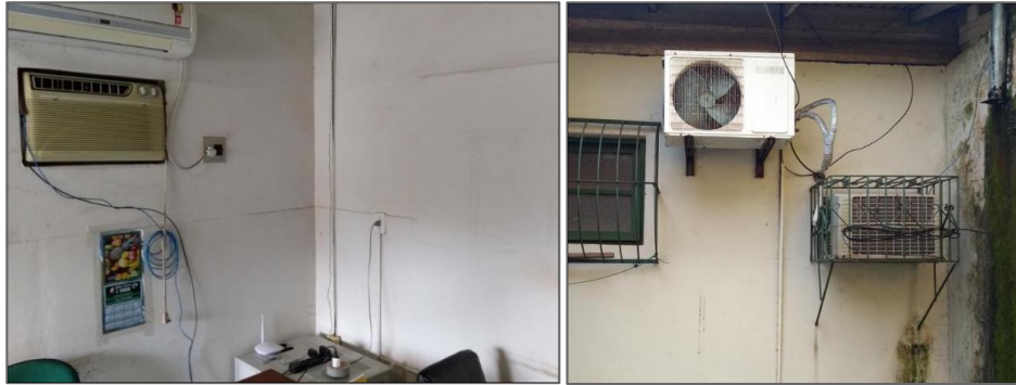
FOTO 06 e 07: INSTALAÇÕES ELÉTRICAS PRECÁRIAS
