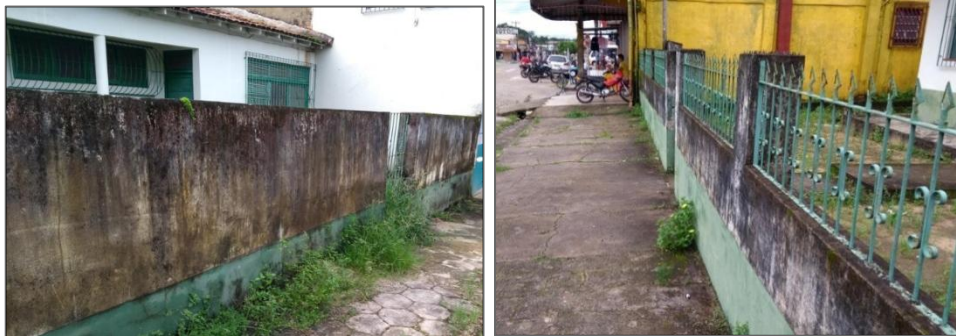
FOTO 02 e 03: ESTADO DA PINTURA E CONSERVAÇÃO DO MURO
