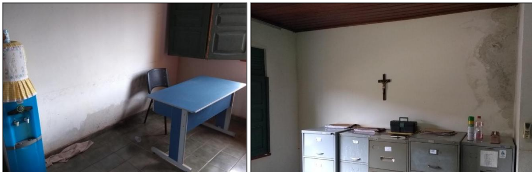
FOTO 04 e 05: INFILTRAÇÕES INTERNAS – TELHADO COM GOTEIRAS
