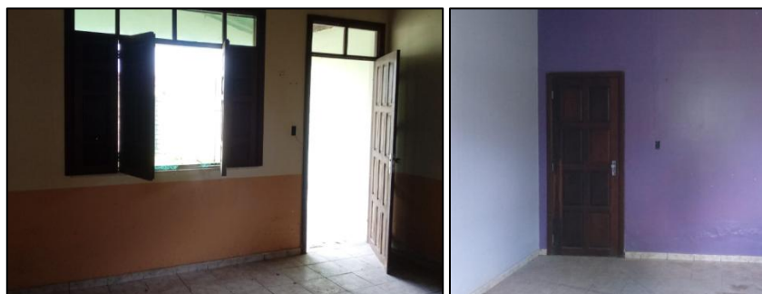
FOTO 03 04: CONDIÇÕES ATUAIS DE PINTURA E PISO
