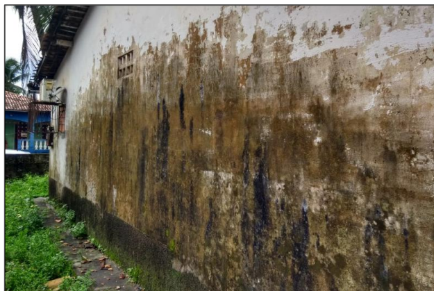
FOTO 04: ESTADO DA PINTURA E UMIDADE EXTERNA EXISTENTE
