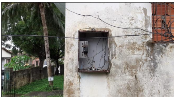
FOTO 01: INSTALAÇÕES ELÉTRICAS EM DESACORDO COM PADRÕES EXIGIDOS PELA CONSECCIONÁRIA
