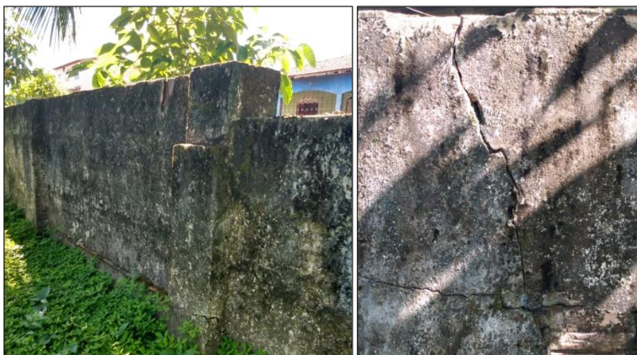
FOTO 05 E 06: MURO – TOMBAMENTO E RACHARUDAS – RISCO IMINENTE
