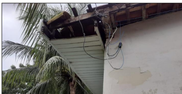
FOTO 02: INSTALAÇÕES ELÉTRICAS EM DESACORDO COM PADRÕES EXIGIDOS PELA CONSECCIONÁRIA / ESTRUTURA DO TELHADO COM PEÇAS DANIFICADAS
