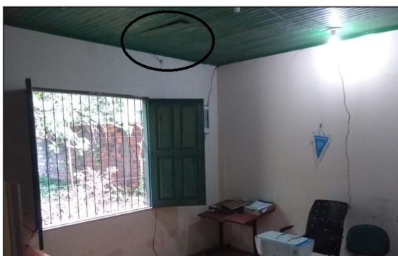
FOTO 03: ESTADO DE CONSERVAÇÃO DO FORRO DE MADEIRA / UMIDADE INTERNA DAS SALAS
