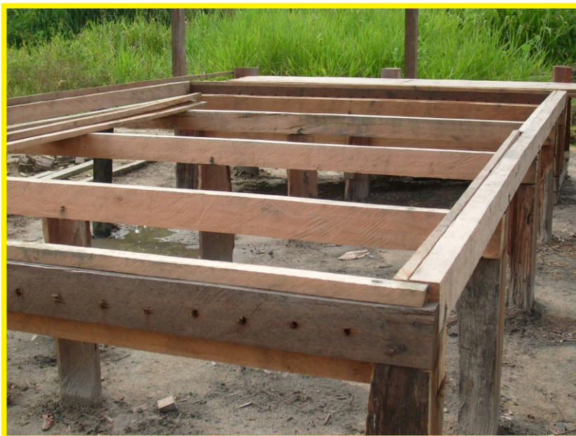
Figura 7 - Vista da estrutura do cocho 20 cm acima do solo Fonte: Acervo EMATER-PARÁ
